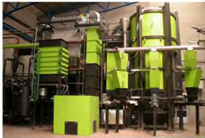
PLANTA DE GASIFICACIÓN DE 6 MW (CAMPO DE CRIPTANA)
