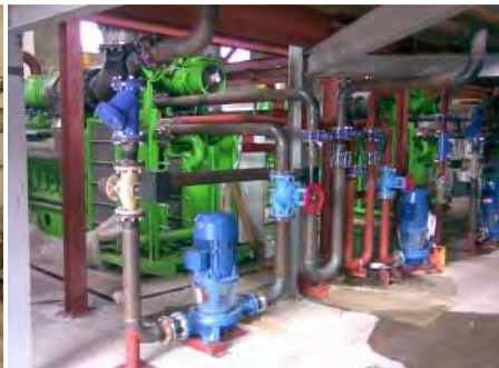
Recuperación de calor motores a gas
