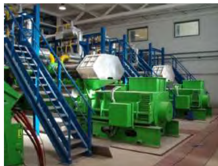
Sala de motores
