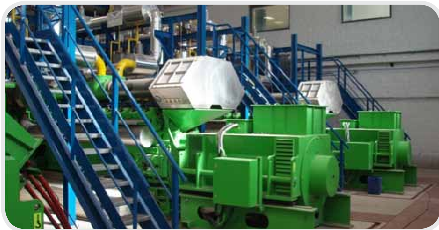
Imagen sala motogeneradores a gas de síntesis de 6 MWe
