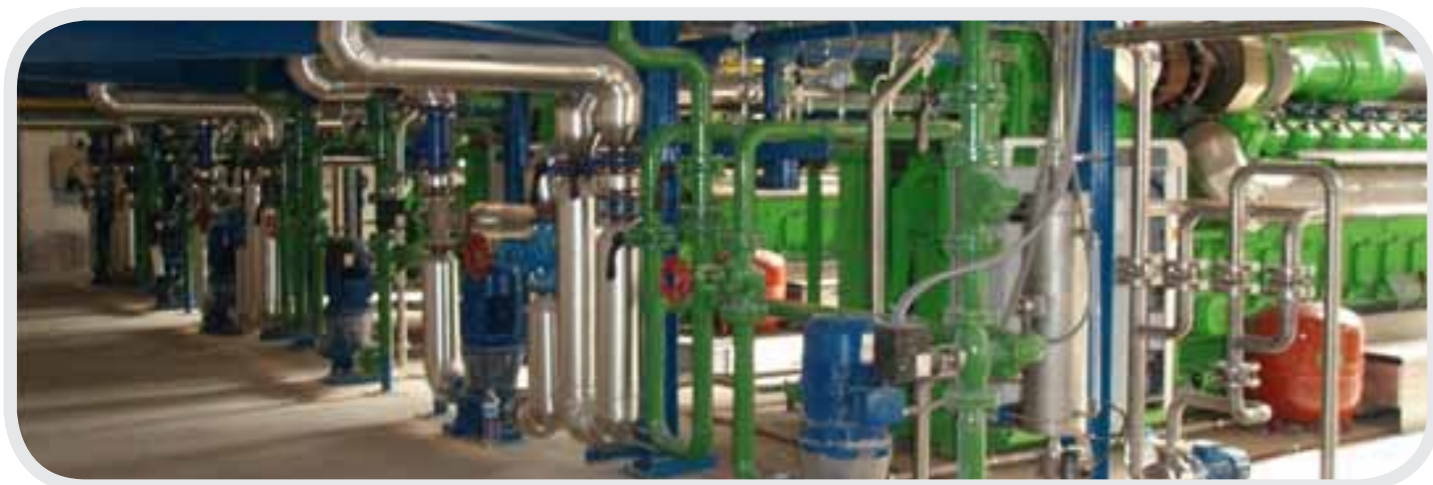
Imagen equipos de recuperación de energía térmica para la producción de agua caliente
